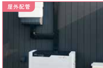
屋外配管 パワーコンディショナへの配管・配線が外壁材の外側を通ります。
