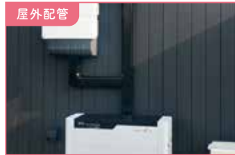
屋外配管 パワーコンディショナへの配管・配線が外壁材の外側を通ります。
