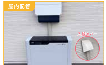
屋内配管 パワーコンディショナへの配管・配線が壁内を通ります。
